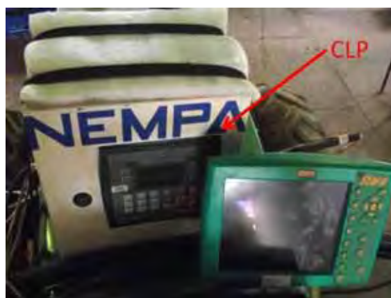
Figura 9. Controlador lógico programável “CLP”
