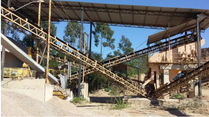
Figura 26 – Setor secundário de peneiramento e trituração da usina RCC
