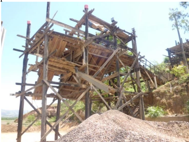
Figura 23 - Detalhe geral do setor secundário do equipamento e os depósitos de materiais produzidos
