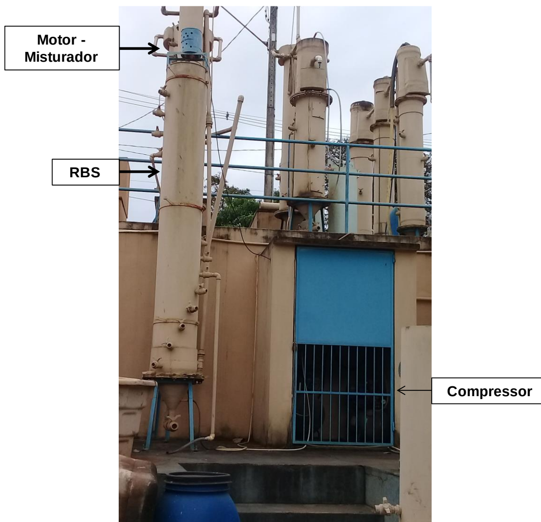
Figura 14: Foto. Sistema aeróbio RBS com motor rotacional e compressor utilizado para aeração do sistema.
