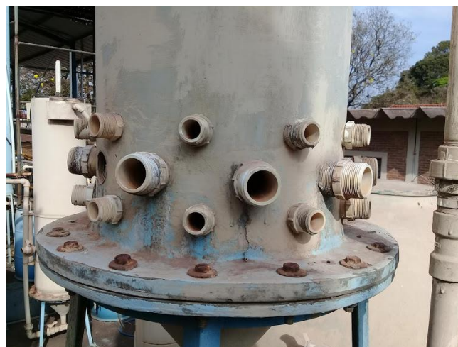
Figura 18. Foto: Orifícios para entrada de ar no filtro biológico percolador.
