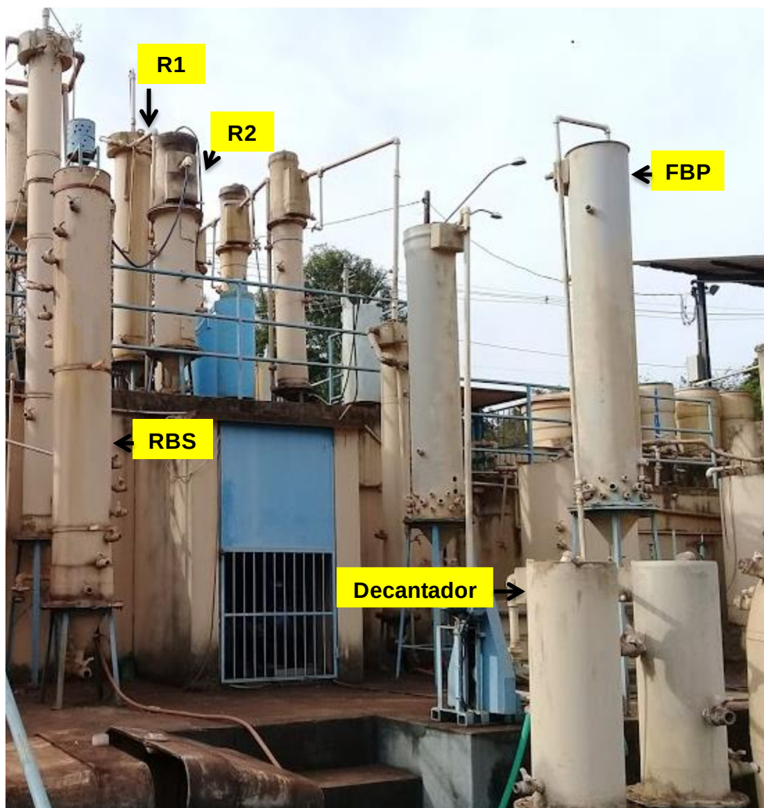
Figura 11. Foto: Sistema de tratamento anaeróbio e aeróbio da água residuária da bovinocultura leiteira. Tratamento anaeróbio: reator anaeróbio de fluxo ascendente (UASB - R1) seguido pelo filtro biológico (FB - R2), sistema aeróbio: reator operado em batelada sequencial (RBS) e filtro biológico percolador (FBP) seguido de decantador.
