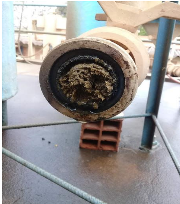
Figura 22. Foto: Cano de alimentação do reator UASB entupido com excesso de fibra.
