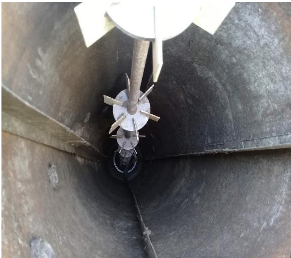
Figura 16: Foto: Interior do RBS com eixo de hastes rotacionais.
