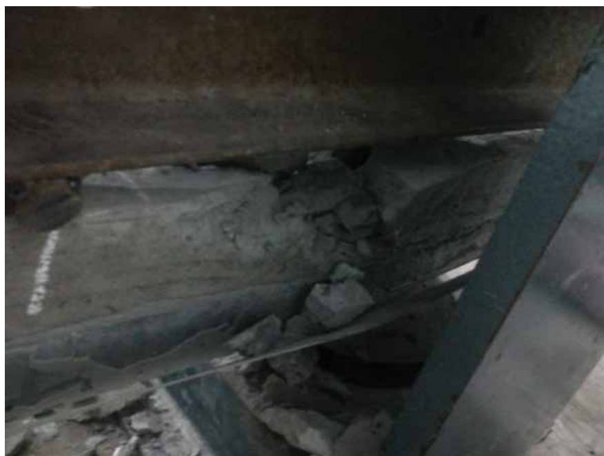
Figura 43: Viga reforçada N o 3 rompida. Fonte: Autor.
