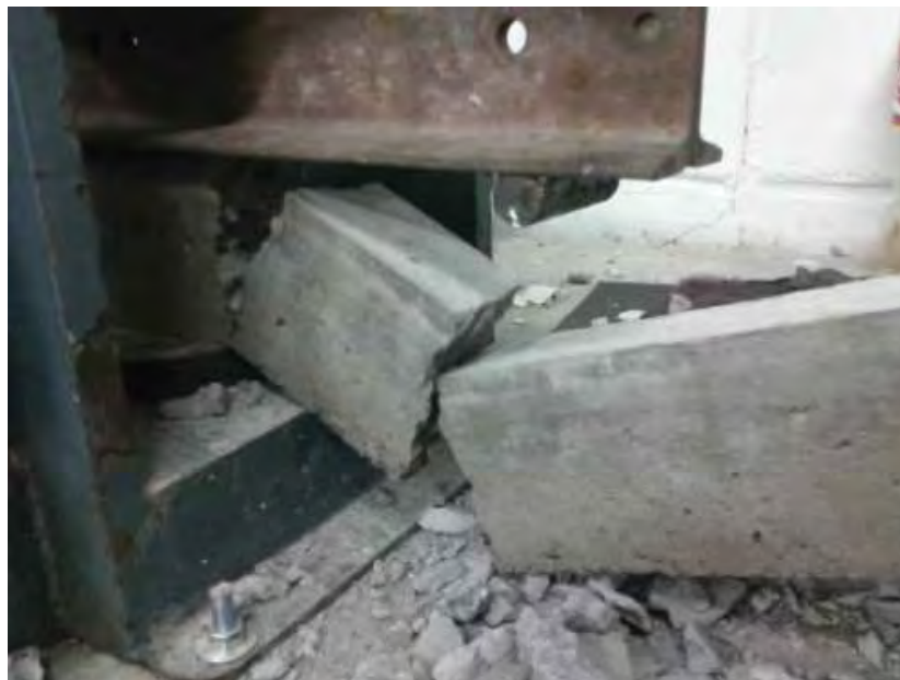
Figura 35: Viga Nº 1 Rompida. Fonte: Autor.
