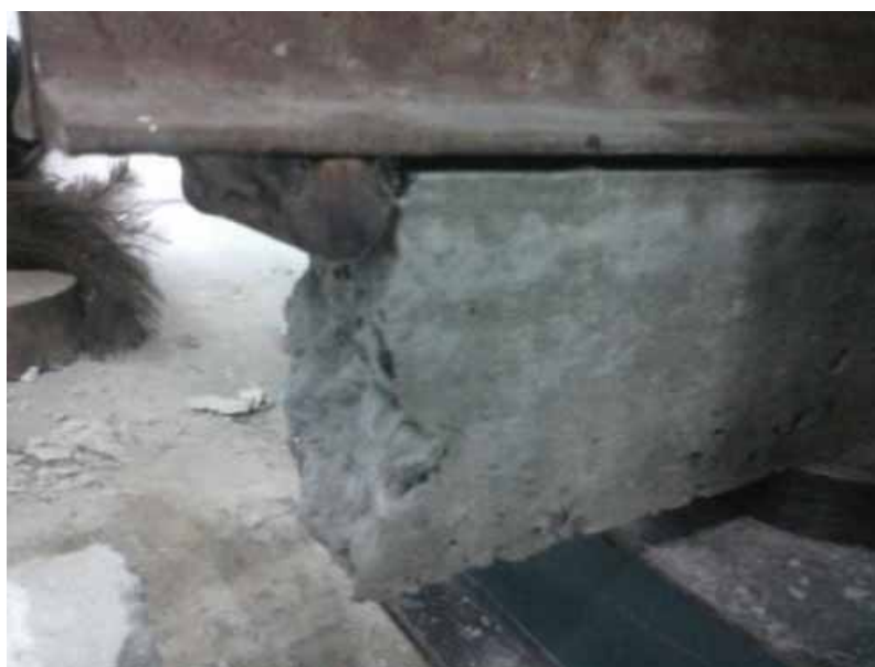
Figura 34: Viga Nº 1 Rompida. Fonte: Autor.
