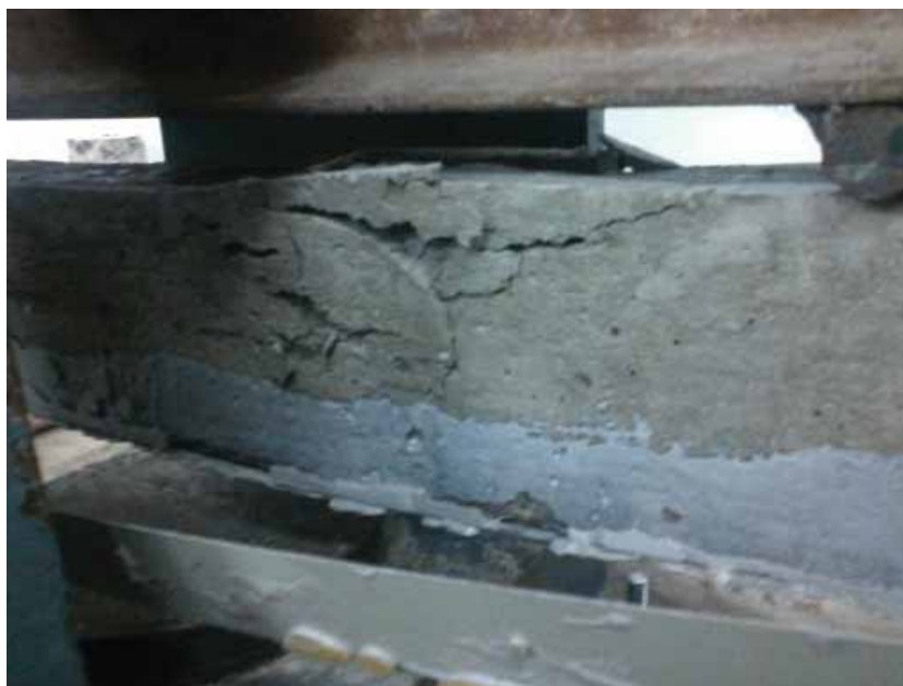
Figura 39: Viga reforçada N o 1 rompida. Fonte: Autor.
