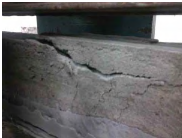
Figura 41: Viga reforçada nº 2 rompida. Fonte: Autor.
