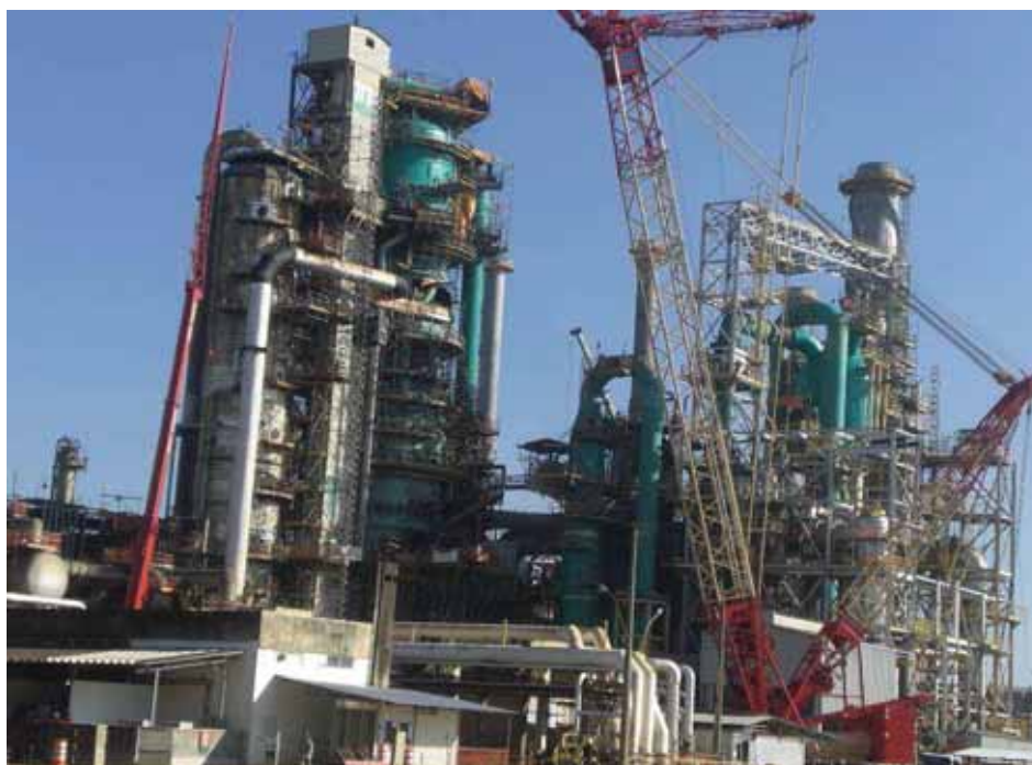
Figura 3 – Vista Geral da Unidade de Craqueamento Catalítico em Leito Fluidizado (UFCC) da REVAP (RAMOS NETO; GUIMARÃES, 2011)
