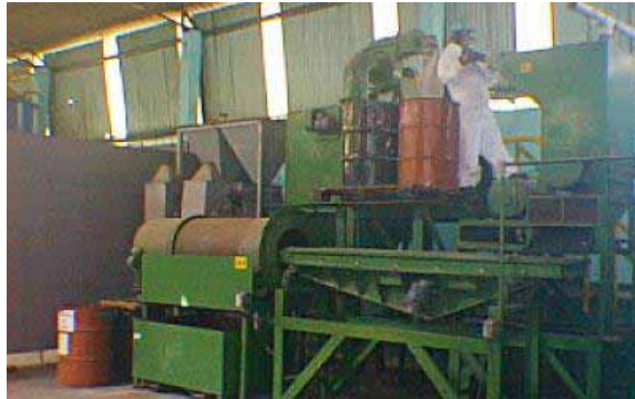
Imagem cedida pela Suzaquim Equipamento de moagem de pilhas e baterias
