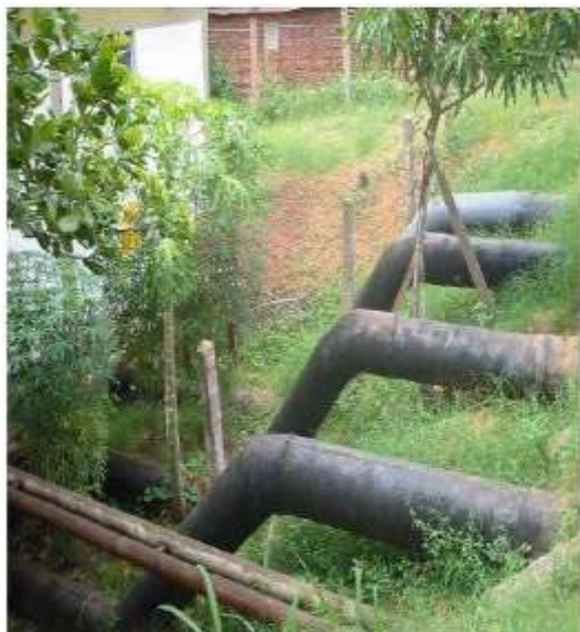
Foto 24 - Dutos de Drenagem Interligando as Lagoas da Porção Norte de Teresina (PI)
