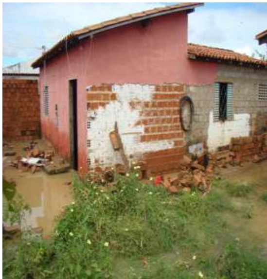
Foto 11 - Ocupação Irregular nas Margens do rio Poti, no Bairro Mocambinho - Teresina-PI - Enchente de 2009
