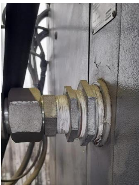
Figura 62 - Instalação inadequada de redução de tubulação
