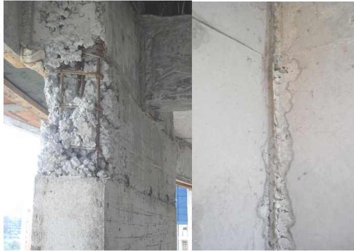
Figura 5.2 – Bicheiras e Segregação do Concreto (Fonte: Especificações Técnicas Gafisa – Estrutura de Concreto Armado, pág. 32).
