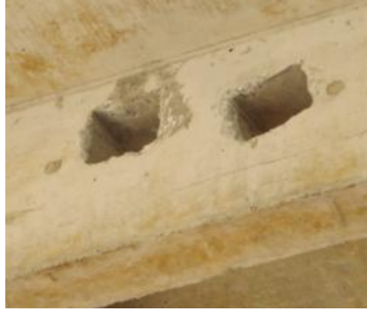
Figura 5.14 - Passantes nas Vigas Executado de Forma Errada (Fonte: http://www.multiquip.com.br ).
