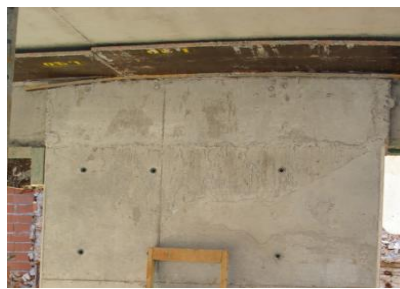
Figura 5.5 – Procedimento Incorreto de Execução das Juntas (Fonte: Especificação Técnica Gafisa – Estrutura de Concreto Armado, pág. 76).
