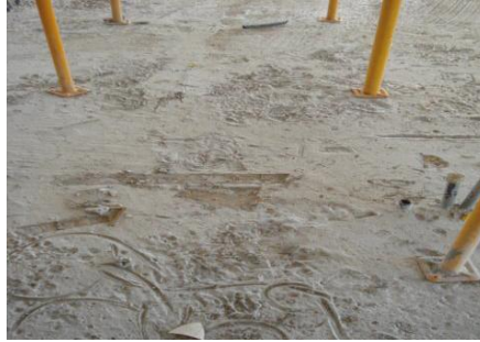
Figura 5.7 - Acabamento Superficial do Piso Executado de Forma Errada (Fonte: http://www.multiquip.com.br ).
