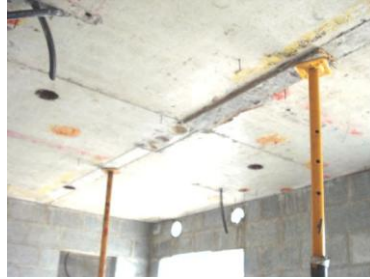
Figura 5.12 Escoras Remanescentes Forma Errada (Fonte: http://www.multiquip.com.br ).
