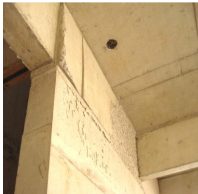
Figura 5.9 - Pilares e Vigas e Laje com Deformação Geométrica Visível (Fonte: http://www.multiquip.com.br ).
