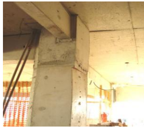
Figura 5.8 - Pilares e Vigas e Laje sem Deformação Geométrica Visível (Fonte: http://www.multiquip.com.br ).
