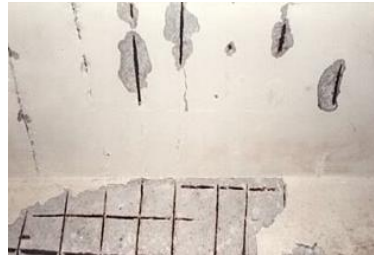
Figura 6.1 – Expulsão do Concreto (Fonte: Especificações Técnicas Gafisa – Estrutura de Concreto Armado, pág. 35).
