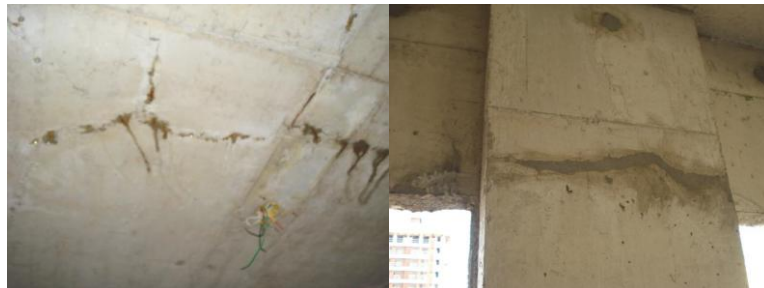
Figura 5.1 – Fissuras e Trincas (Fonte: Especificações Técnicas Gafisa – Estrutura de Concreto Armado, pág. 17).
