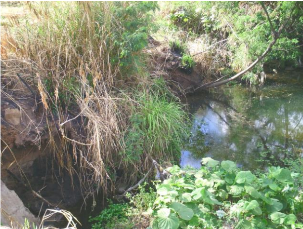
FIGURA 8. Processos erosivos na Av. 10. Fonte: Grazielle Ost. Agosto/2012.
