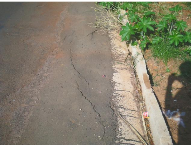
FIGURA 10. Rupturas no asfalto devido à erosão. Fonte: Grazielle Ost. Agosto/2012.
