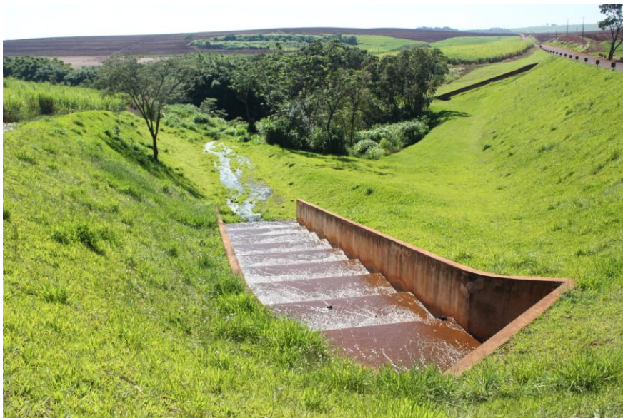
Figura 14. Canal de escoamento chegando ao curso natural do rio. (750597m de longitude e 7493213m de latitude).
