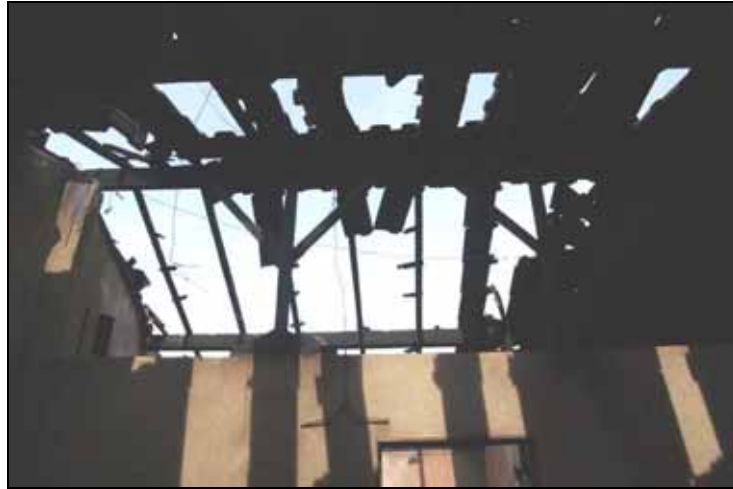
Figura 7 - Estrutura de um telhado após um incêndio. Fonte: Próprio Autor (2008)
