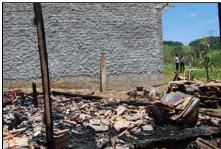
Figura 8 - Pilar roliço em situação de incêndio real. Fonte: Próprio Autor (2009)
