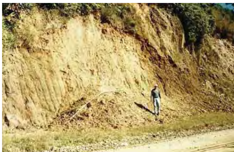
Figura 65: Deslocamentos em abertura de estrada (MESQUITA, 1998).
