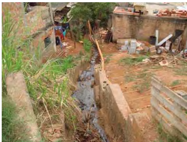
Figura 34: Esgoto a céu aberto (SATO, 2007).
