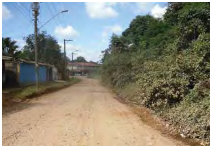
Figura 61: Recuperação do talude através de vegetação (MESQUITA, 2010).
