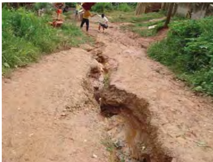
Figura 32: Ravinamento em arruamento (SATO, 2007).
