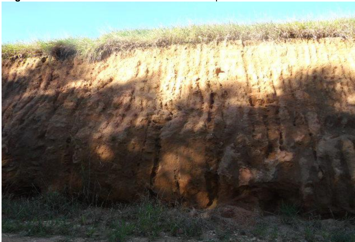
Figura 34. Sulcos erosivos em talude no município de Santo Antônio do Jardim
