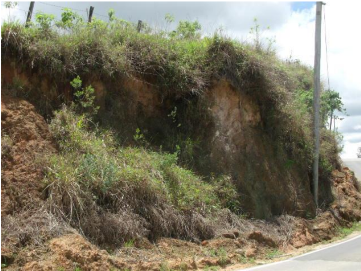
Área de risco a escorregamento em talude da rodovia São João da Boa Vista a Santo Antônio do Jardim
