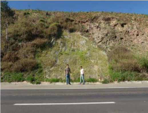
Vista para leste da unidade 4 (talude da rodovia SP-342). Onde houve escorregamento circular.
