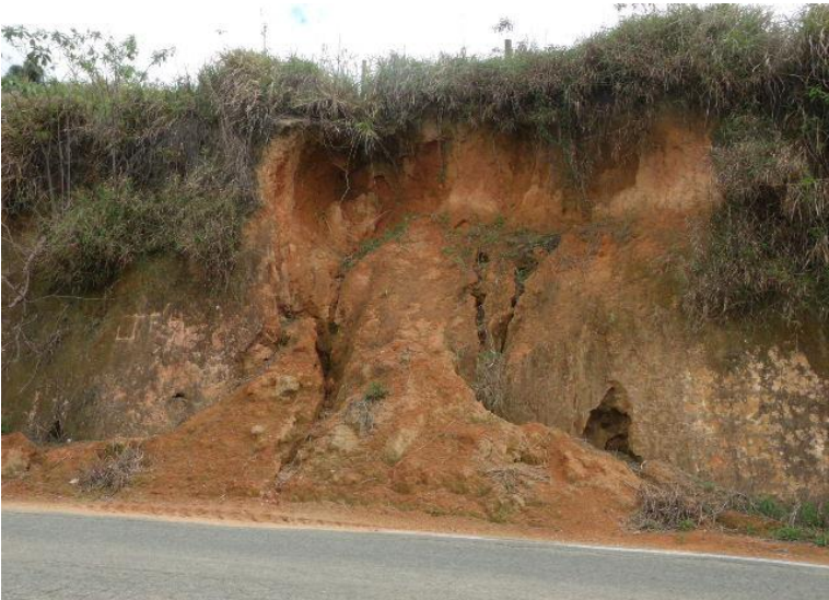
Vista para noroeste do compartimento 9. Erosão linear.
