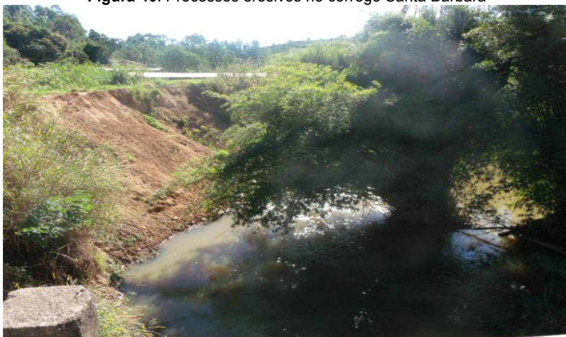
Figura 40. Processos erosivos no córrego Santa Barbara
