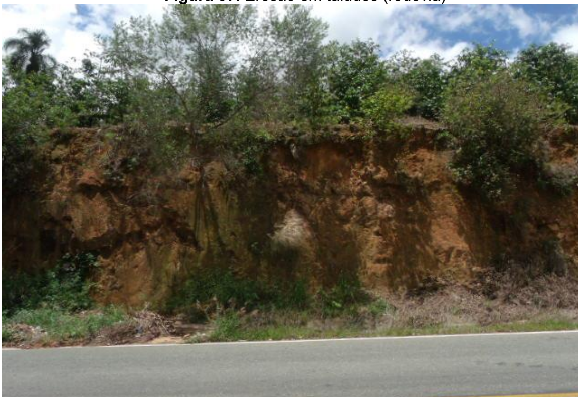
Figura 37. Erosão em taludes (rodovia)
