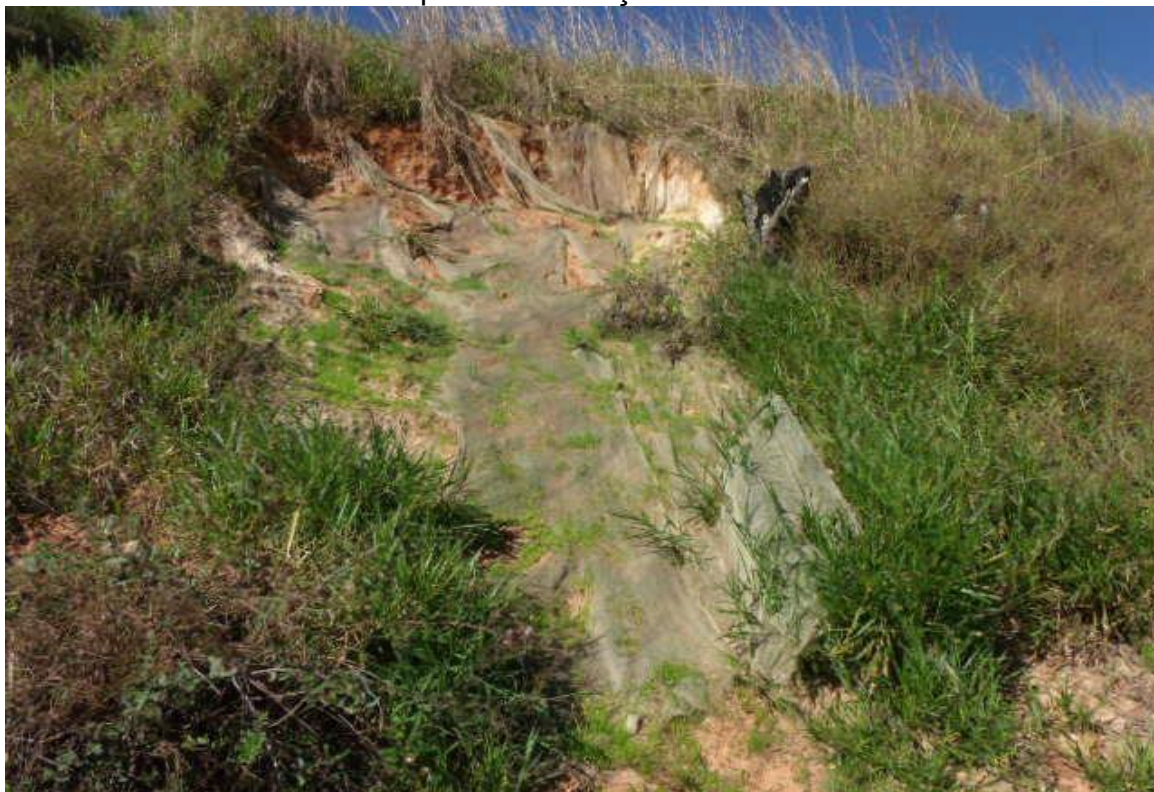
Figura 33. Escorregamento circular sem a devida manutenção sobre a medida adotada para a contenção do fenômeno.
