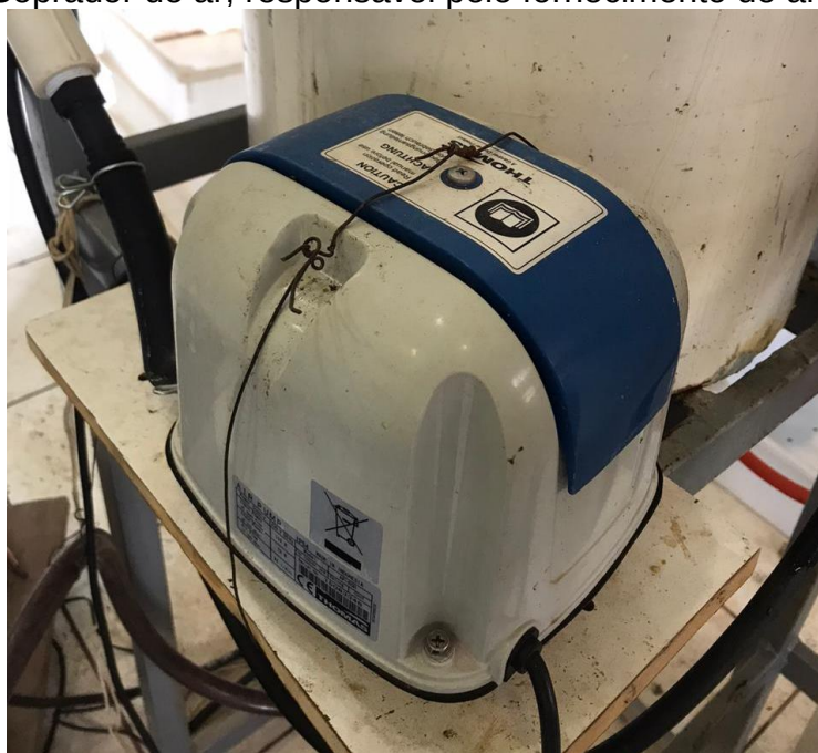
Figura 12 - Soprador de ar, responsável pelo fornecimento de ar a membrana
