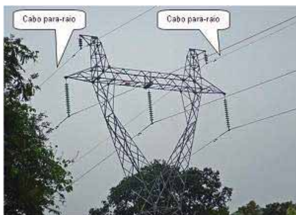
Figura 3: Imagem linha de transmissão protegida por cabo guarda: Disponível em: http://www.radiosorriso.com.br . Acesso em: 18 abr. 2011
