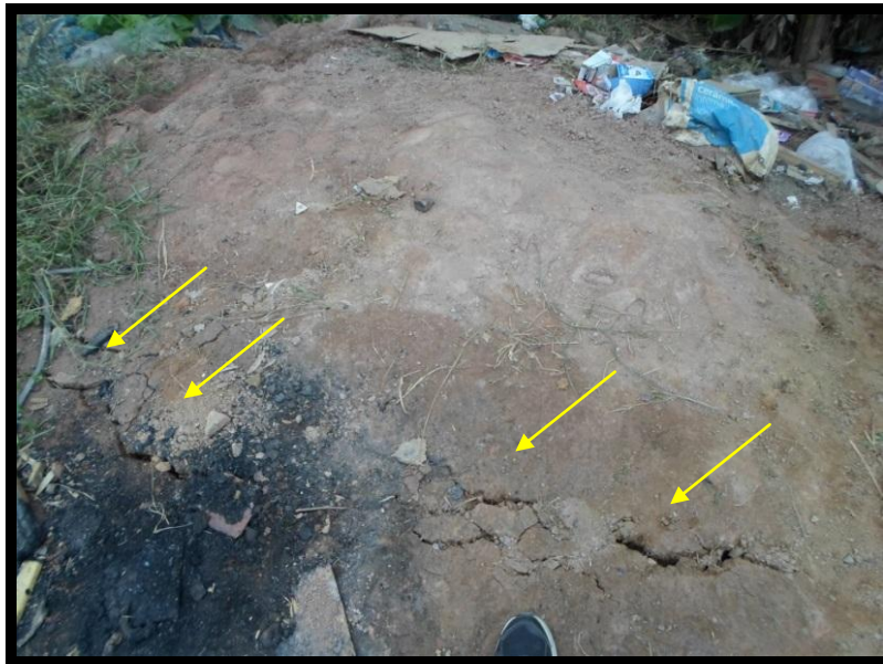
Figura 52 - Rachadura no chão: possível evidência de movimentação de terra
