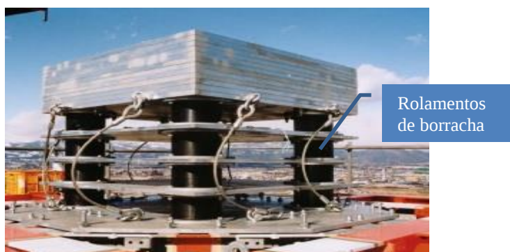
Figura 2 – AMS instalado em torre de antena.
