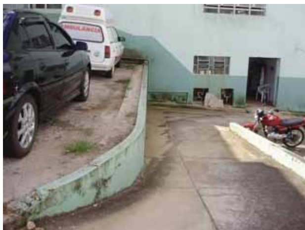
Figura 31 – Rampas com inclinação inadequada e piso mal conservado.
