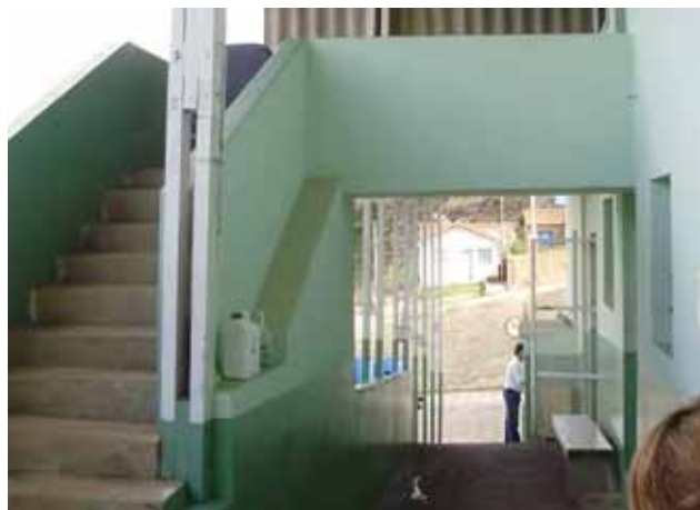
Figura 30 – Escada externa sem sinalização adequada e sem corrimãos.
