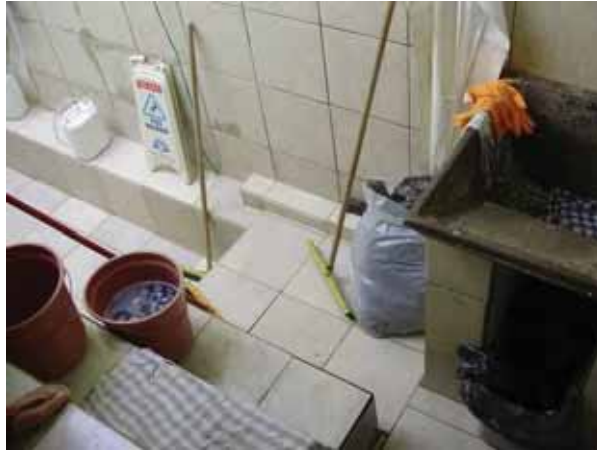
Figura 28 – Área de serviço com espaço insuficiente.
