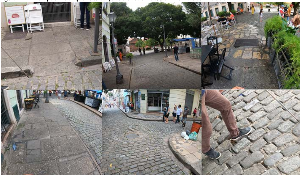
Figura 22 – Rampas inadequadas, calçadas obstruídas, pavimento desnivelado
