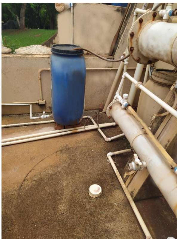
Figura 8. Reservatório para armazenamento do efluente do sistema composto pelos reatores anaeróbios horizontais de leito fixo e alta taxa - RAHLF.
