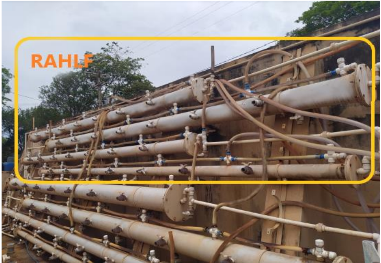
Figura 5. Sistema de tratamento composto por reatores anaeróbios horizontais de leito fixo e alta taxa (RAHLF) – R1, R2, R3 e R4.
