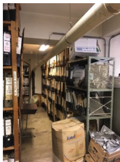
Figura 4. Tubulação de esgoto sob o corredor central do APPMM.
