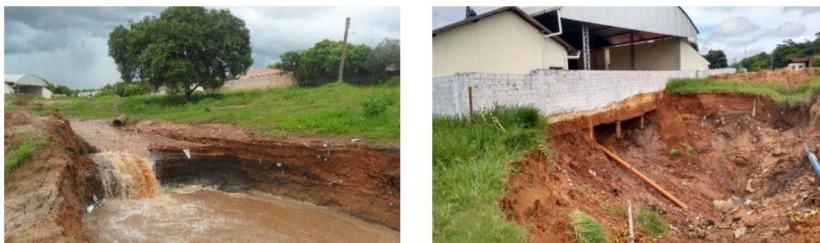
Figura 28- Montagem de imagens de danos provocados após rompimento de galeria em Presidente Venceslau-SP, 2017- Acervo da autora
