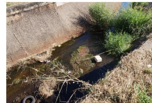
Fotografia 35: Depósito de lixo na calha do córrego. MORAES, 2017.
