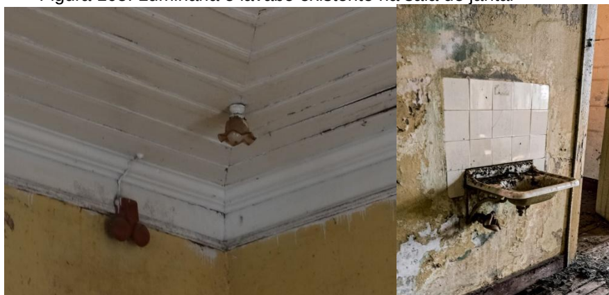
Figura 105: Luminária e lavabo existente na sala de jantar
