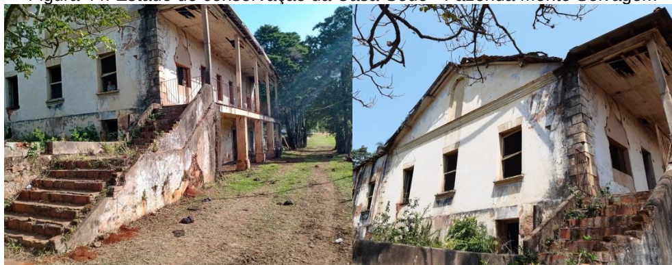
Figura 44: Estado de conservação da Casa-Sede - Fazenda Monte Selvagem
