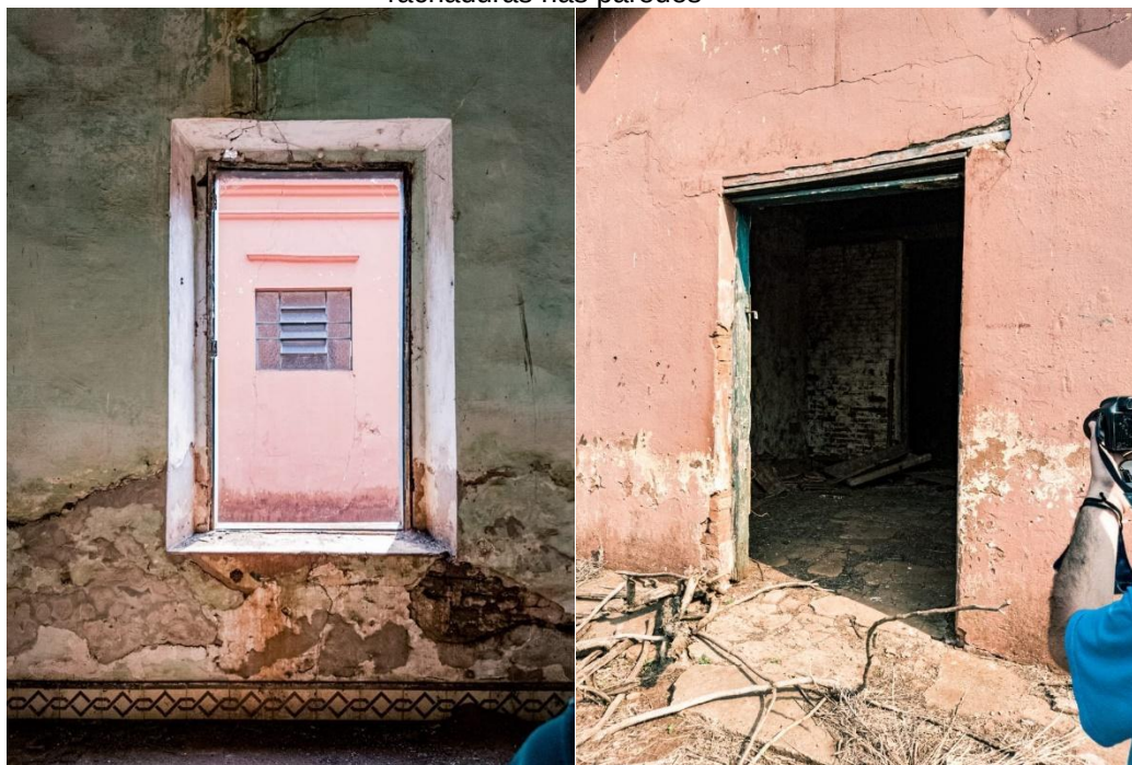
Figura 100: Contraste espaço interno do banheiro e fachada externa, presença de mofo e rachaduras nas paredes
