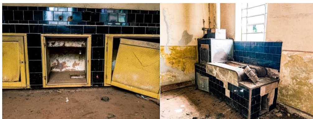
Figura 106: Armário embutido revestido com pastilha cerâmica e fogão a lenha presentes na cozinha
