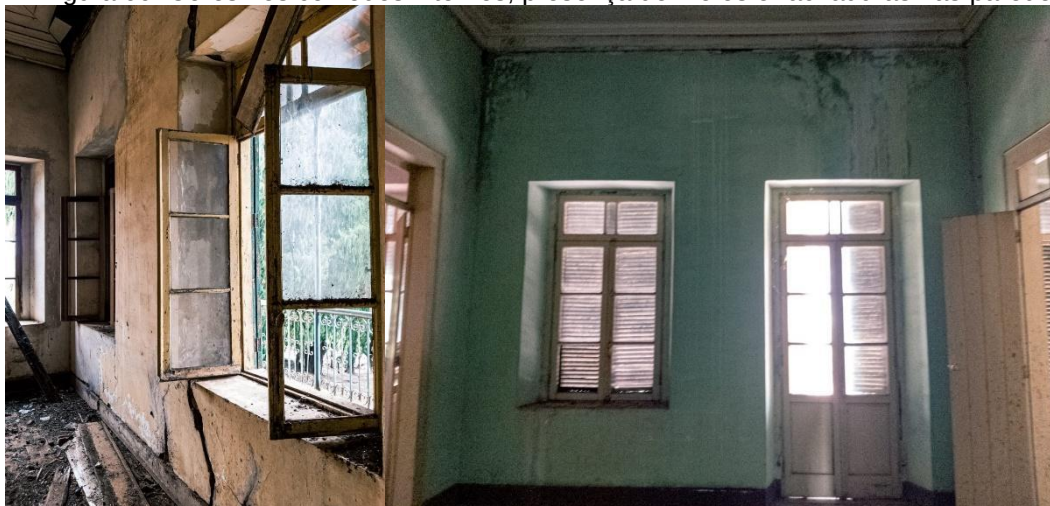
Figura 99: Cores nos cômodos internos, presença de mofos e rachaduras nas paredes
