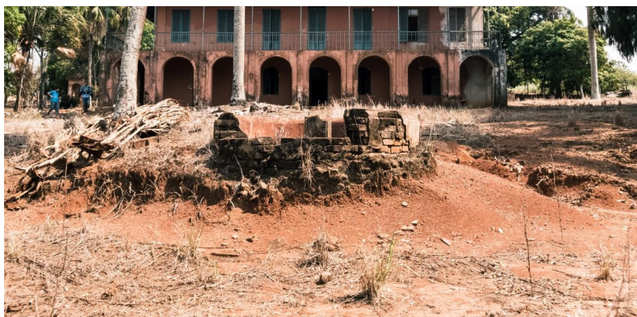
Figura 108: Atual estado de conservação do repuxo d'água
