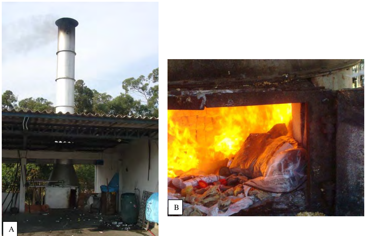
Figura 14 A e B: Forno utilizado para tratamento de resíduos infectantes do HC-FMB
