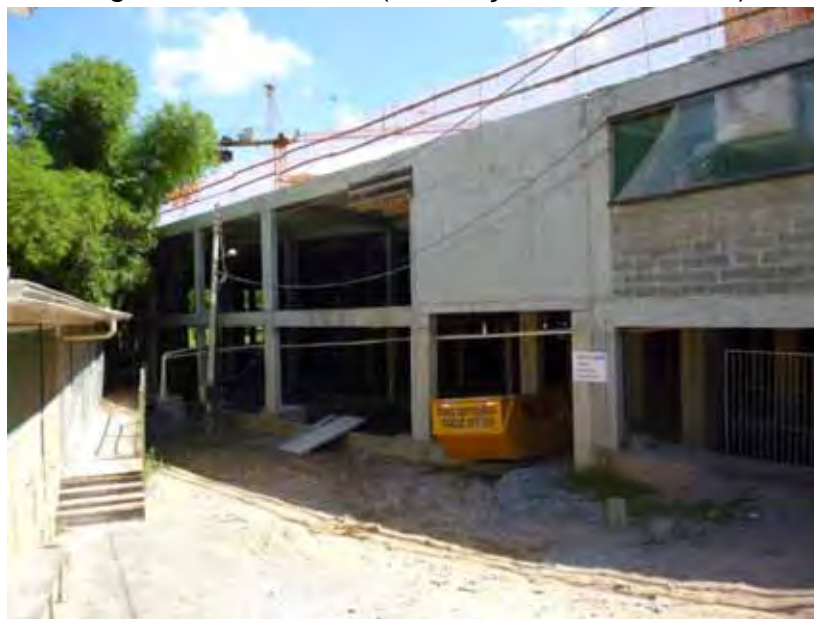
Figura 98 - Subsolo (contenção de enchentes)
