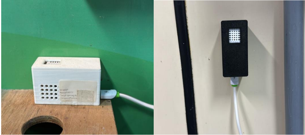
Figura 8: Sensor instalado na sala do tomógrafo 1. Figura 9: Sensor instalado na sala do tomógrafo 2.
