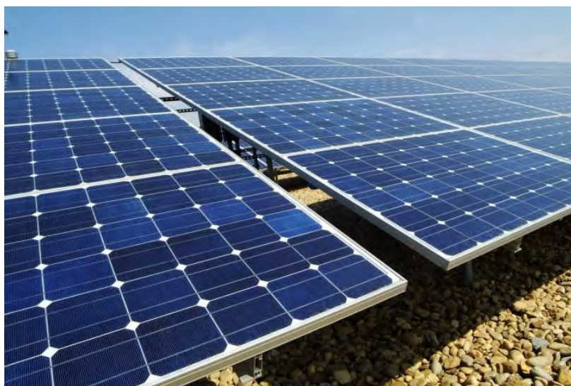
Figura 4. Instalação Fotovoltaica em Campinas (LILLO BRAVO et al. 2004)
