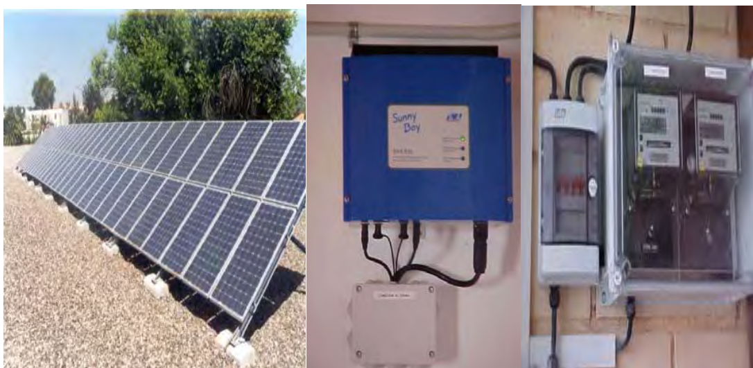
Figura 2. Painel e contadores de instalação de conexão a rede. (LILLO BRAVO et al. 2004)
