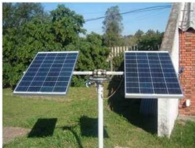
Figura 9 - Estrutura móvel com dois painéis solares
