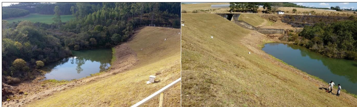
Figura 5 – Fotografias de detalhe da área alagada em porções da base do talude de jusante.
