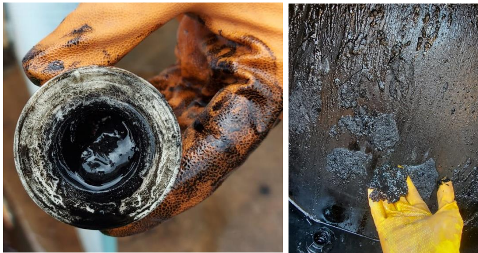
Figura 12. Incrustações observadas na tubulação e caixa do afluente durante a operação dos reatores anaeróbios horizontais de leito fixo (RAHLF), na fase II.
