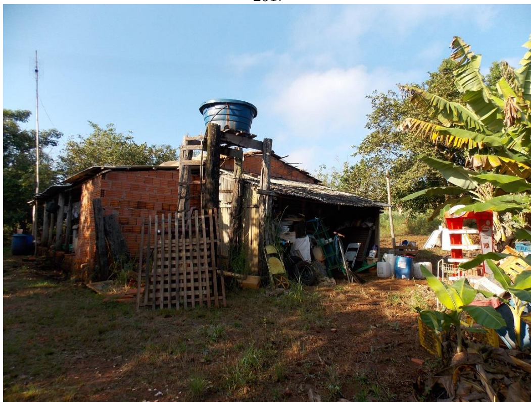
Figura 25 - casa de alvenaria com estrutura precária encontrada no Assentamento Camaquã, 2017
