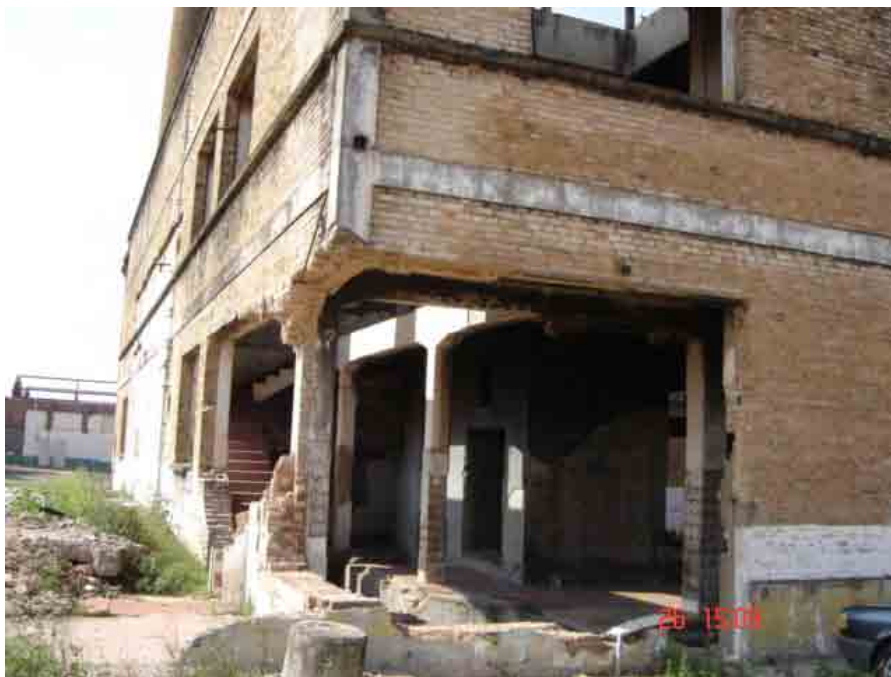
Foto 7: Destruição recente de uma das paredes das IRFM. (Foto: Rodrigo Modesto Nascimento, 2005).
