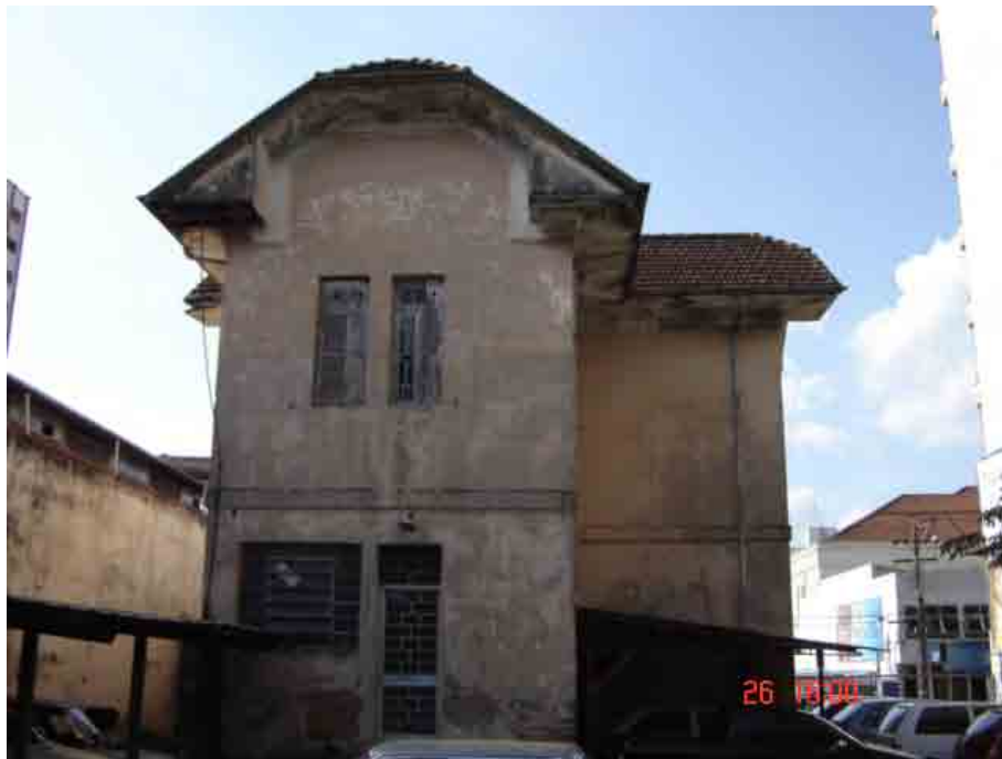
Foto 10: Fundos do bem cultural. Observa-se o mau estado de conservação do imóvel. (Foto: Rodrigo Modesto Nascimento, 2005).
