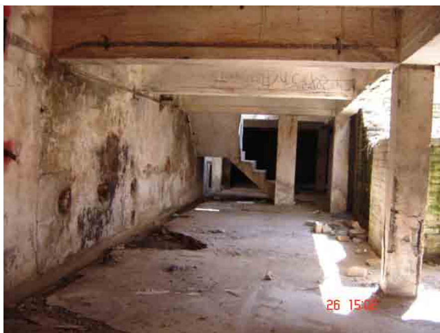
Foto 6: Vista interna das IRFM. Nota-se o estado de abandono e de ruínas em que se encontra o bem cultural tombado pelo Condephaat. (Foto: Rodrigo Modesto Nascimento, 2005).
