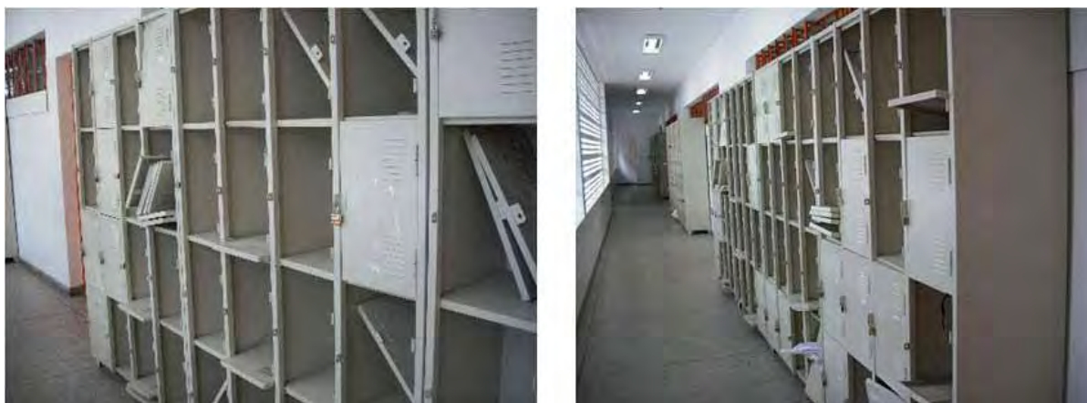
Figuras 4 A e 4 B: Armários quebrados nos corredores da escola.
