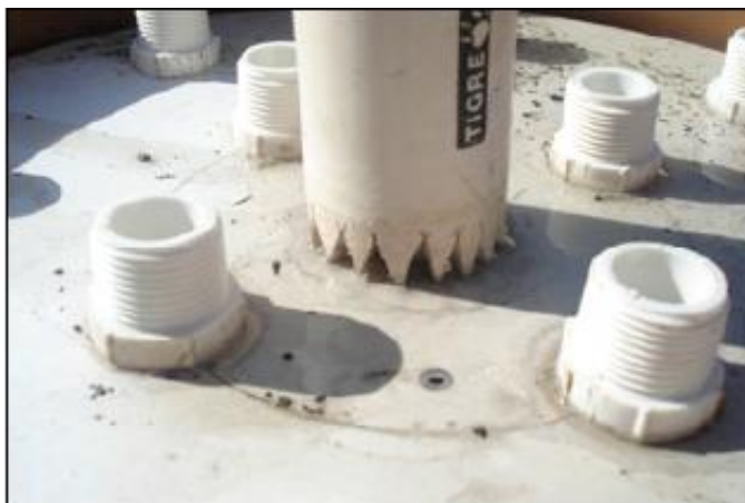
Figura 10. Foto do sistema de distribuição de efluente do filtro biológico percolador utilizando uma placa perfurada de PVC.
