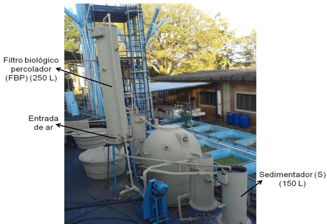
Figura 7. Foto das instalações experimentais do sistema de pós – tratamento composto filtro biológico percolador (FBP) seguido do sedimentador (S).
