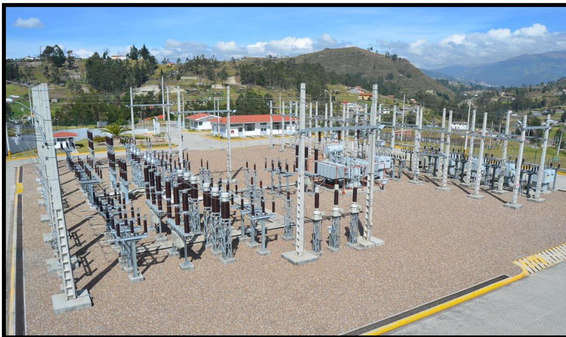
Figura 38. Subestação S/E 08, com capacidade atual de 24/32 MVA
