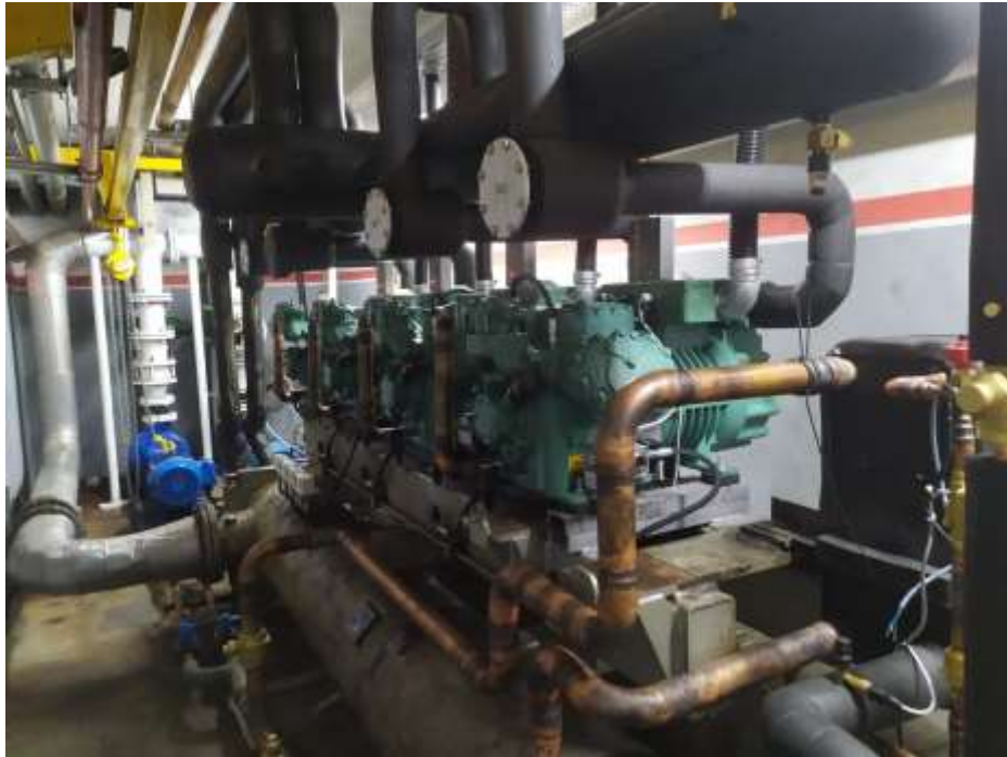
Figura 17 – Sistema de refrigeração novo.
