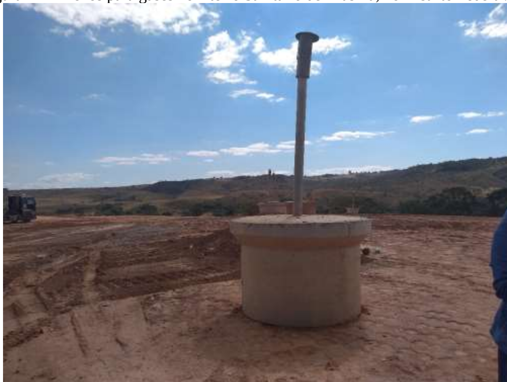
Figura 12 - Drenos para gases no Aterro Sanitário de Brasília, no Distrito Federal/DF.
