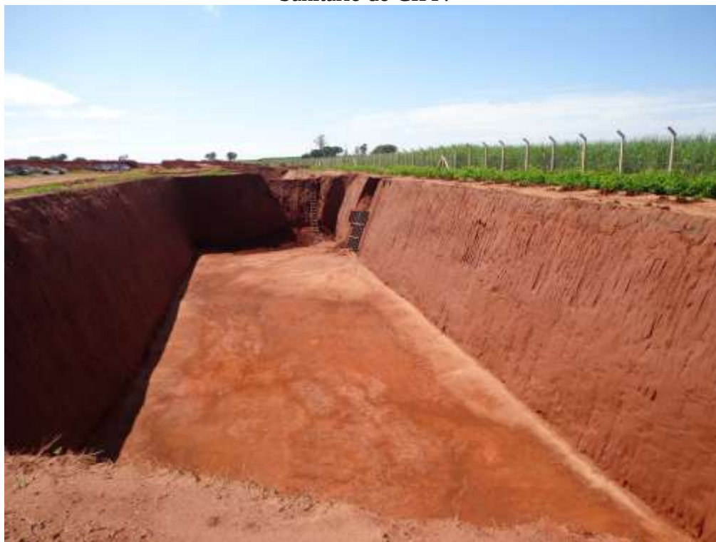
Figura 67 - Lagoa para acúmulo do percolato (chorume e águas das chuvas) no Aterro Sanitário do CIPP.
