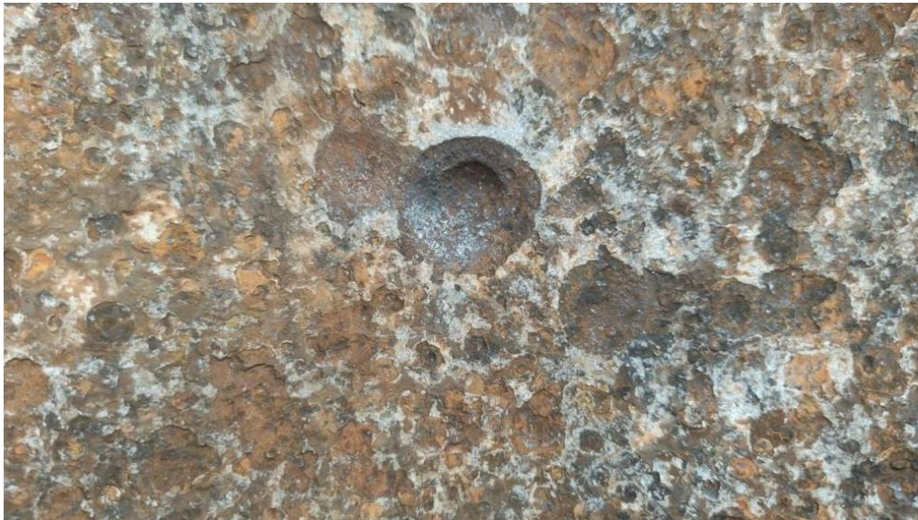
Figura 18 - Detalhes do desgaste devido à presença de cavaco e contaminantes na água de resfriamento
