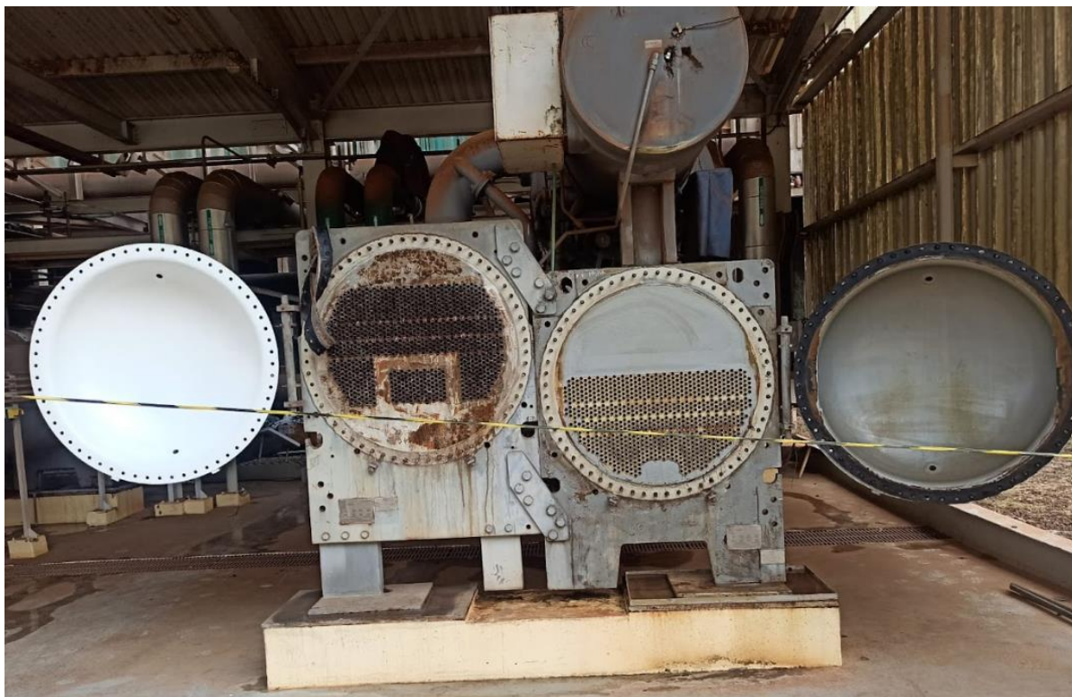
Figura 19 – Condensador (esquerda) e evaporador (direita) após tratamento
