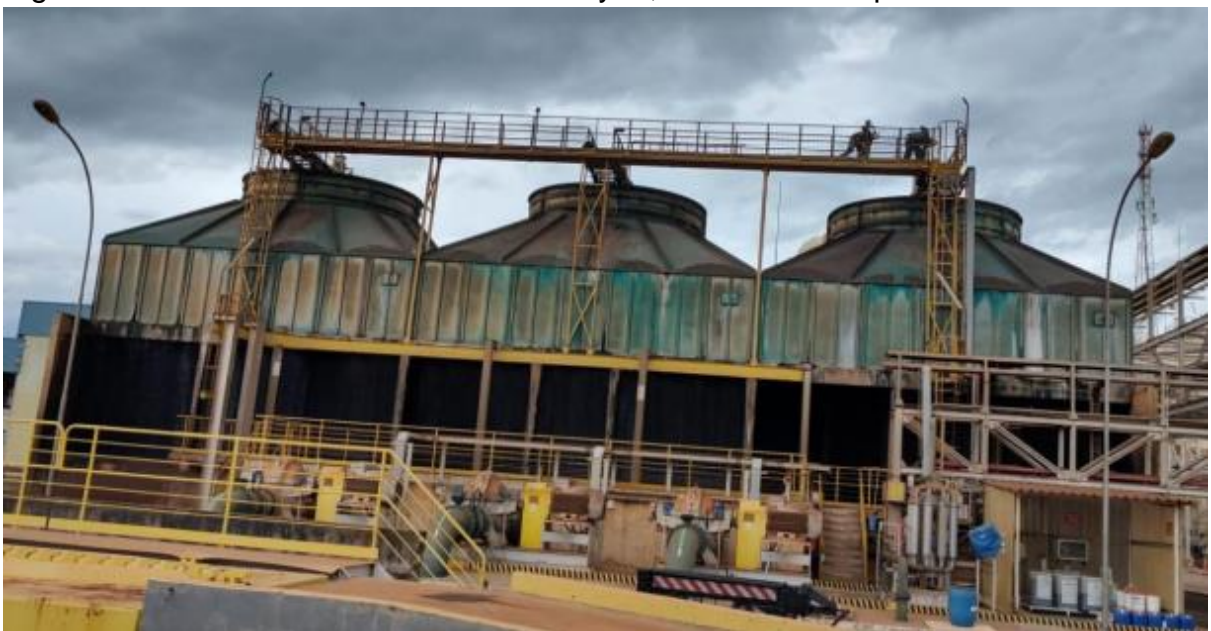
Figura 14 - Torre de resfriamento da Nouryon, Unidade de Jupirá
