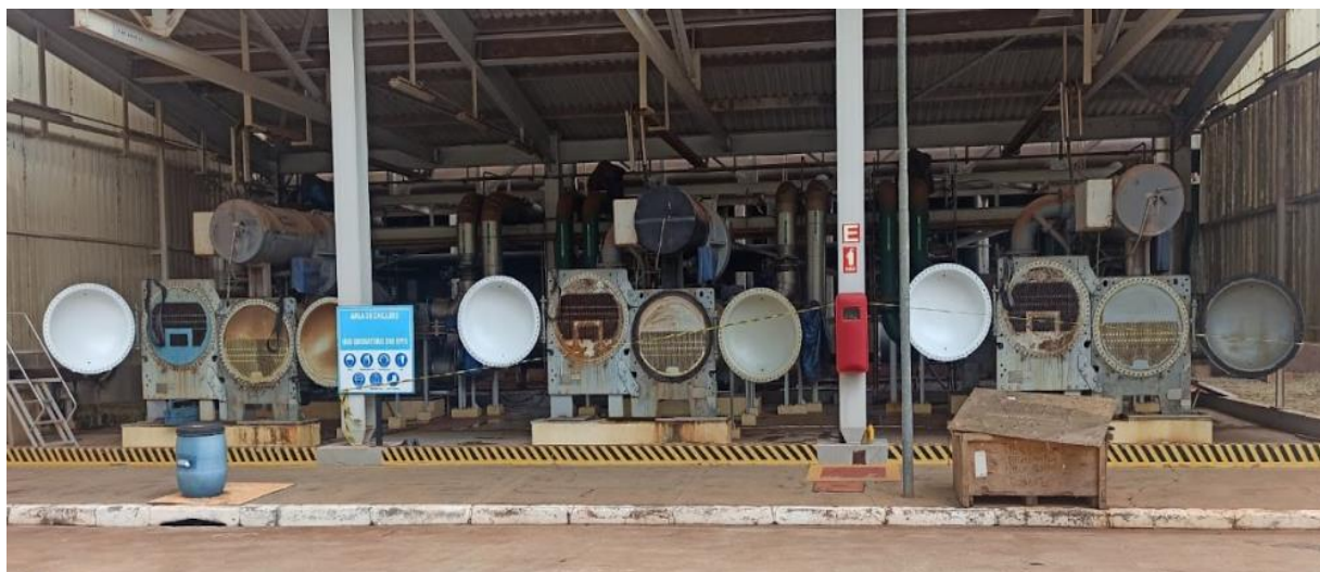
Figura 15 – Conjunto de Water-Cooled Chillers - Unidade de Jupiá da Nouryon Pulp and Performance Chemicals
