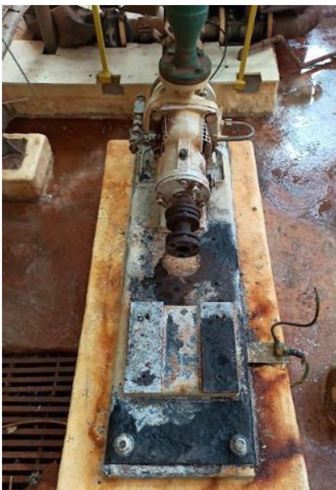
Figura 9 - Base de bomba deteriorada
