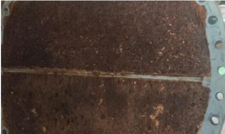
Figura 16 - Tampa traseira do evaporador antes do tratamento
