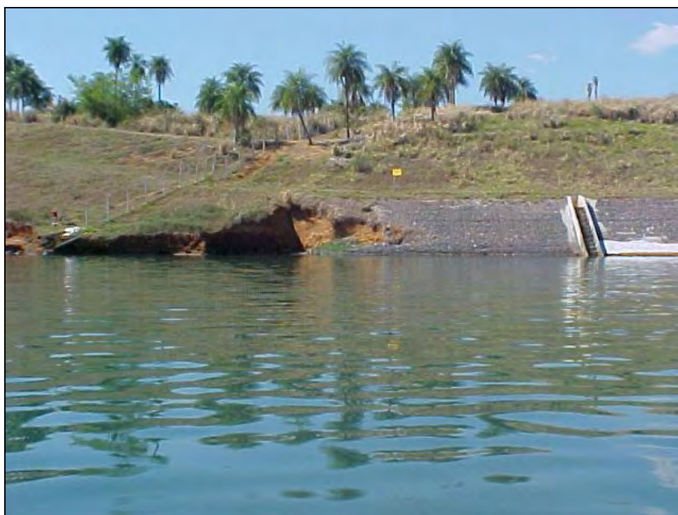
Foto 35: Rompimento de gabiões em encostas do rio Paraná
