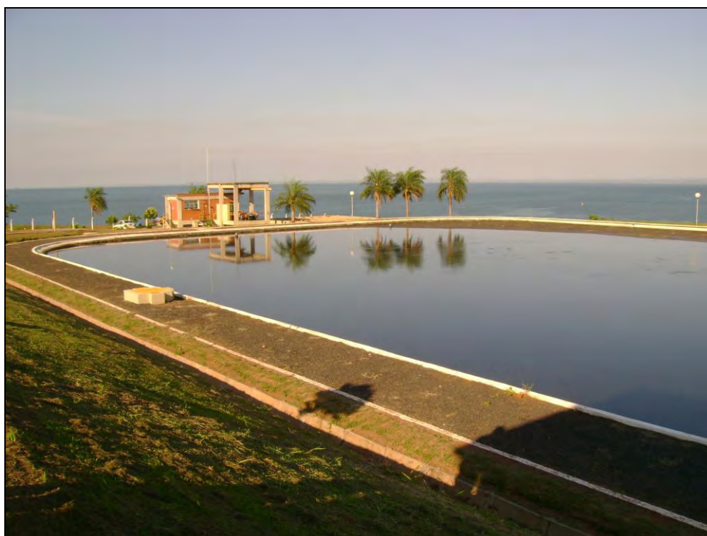
Foto 15: Lagoa de estabilização – Estação de Tratamento de Esgotos – Presidente Epitácio
