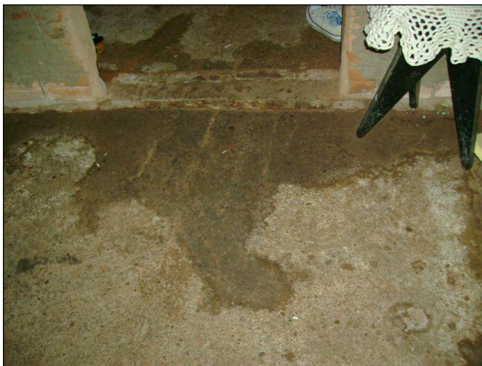
Foto 29: Umidade no interior do piso da casa de um morador da Vila Martins Autor: Ricardo dos Santos, 2009.
