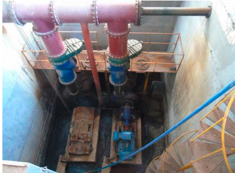
Figura 23: Bomba de recalque da Estação Elevatória
