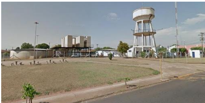
Figura 22: Poço profundo do sistema Matéria
