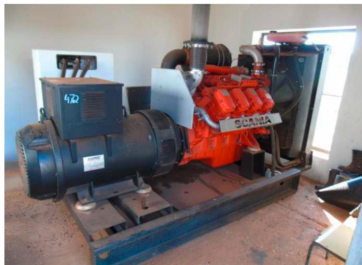
Figura 24: Gerador de energia
