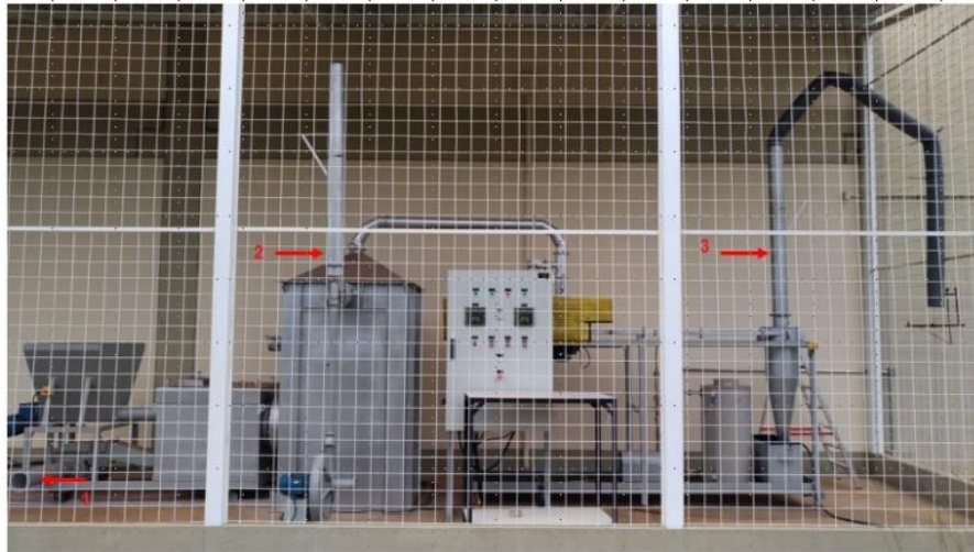
Figura 11. Pontos de medições de velocidade no queimador piloto (setas vermelhas nos pontos de amostragem 1,2 e 3)
