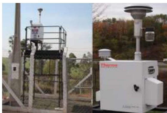
Figura 4.3 - Estação de monitoramento da qualidade do ar instalada no bairro da Assistência, com realce para o amostrador Partisol 2025i
