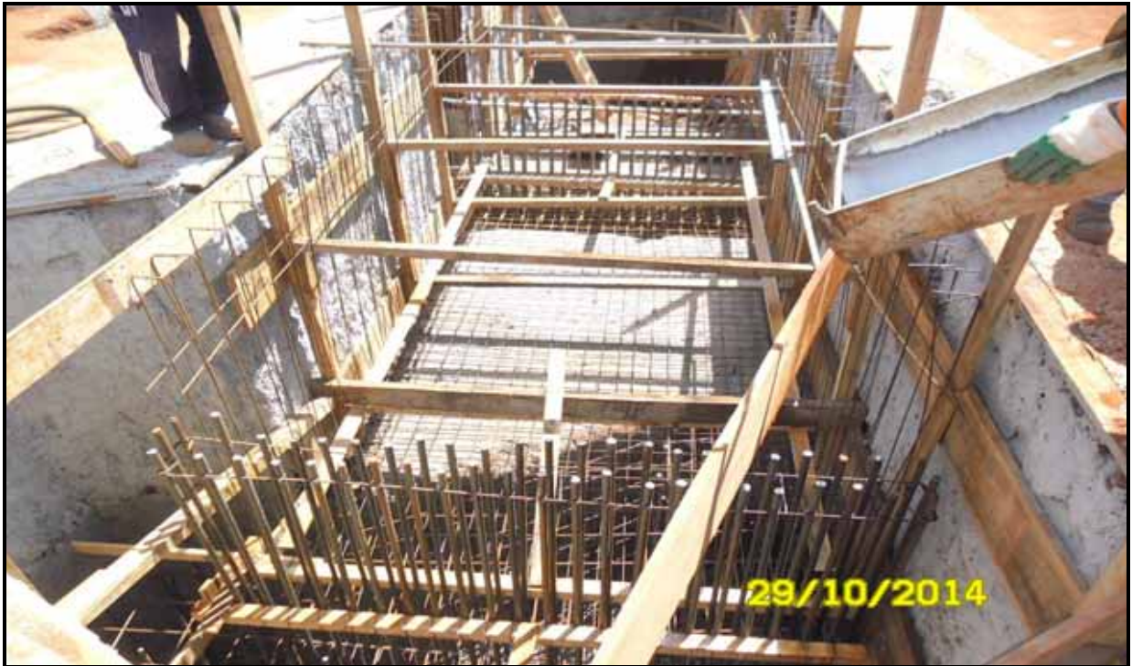
Figura 11–Nesta fase da obra utilizou-se mão de obra de: armadores, pedreiros e carpinteiros.
