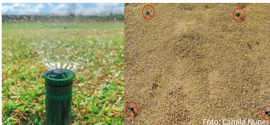
Figura 7 – Aspersor 1804 em funcionamento
