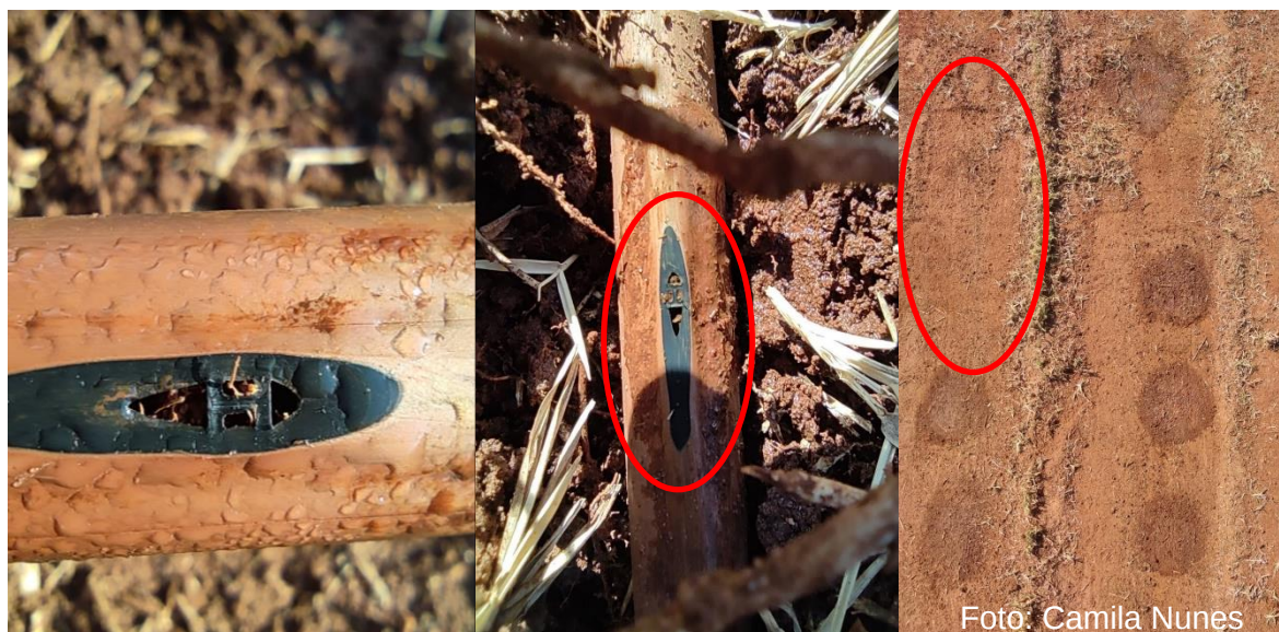
Figura 15 – Entupimento dos gotejadores acarretando má distribuição de água dentro das subparcelas
