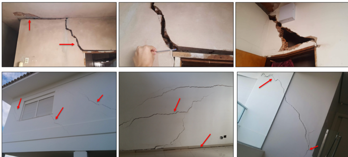
Figura 3.11 – Construções afetadas pelo colapso do solo na região de Bauru-SP.
