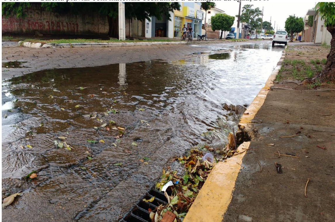
Foto 44 – Galeria pluvial com materiais obstruindo a drenagem da água, 2019
