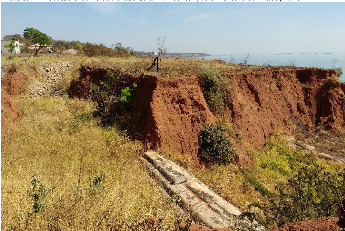
Foto 39 – Processo erosivo acelerado de difícil contenção em área urbanizada, 2018
