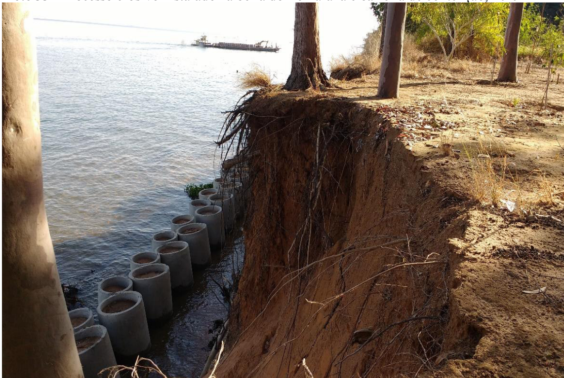
Foto 33 - Processo erosivo instalado na beira do rio Paraná e barreira de contenção, 2019
