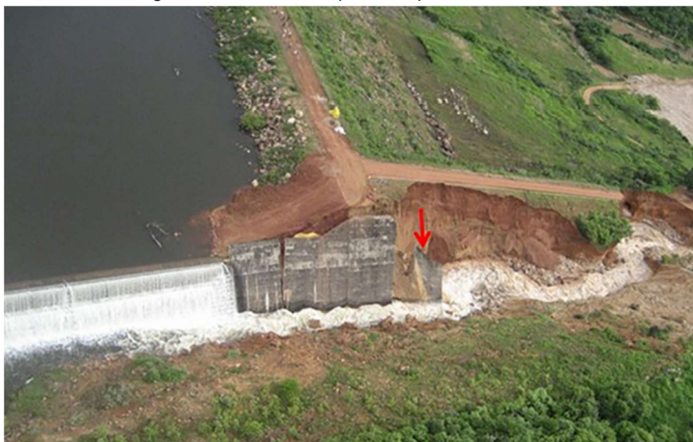
Figura 22 – Queda da primeira placa de concreto
