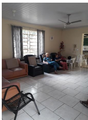
Figura 79 – Janela da sala de estar da ILPI II, não tem o dimensionamento adequado para iluminação e ventilação natural.
