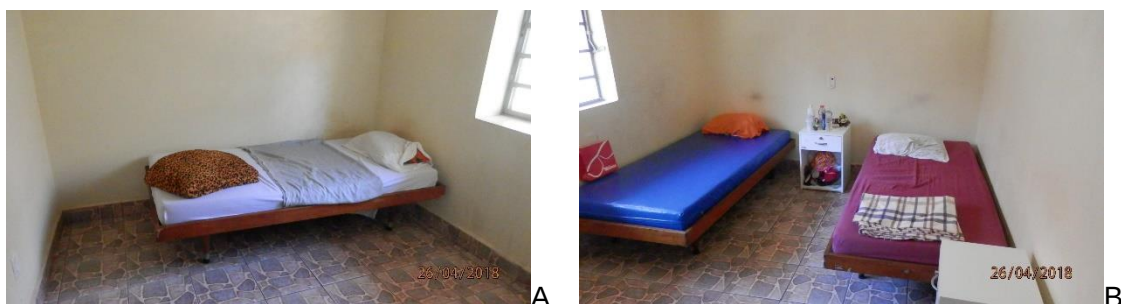
Figuras 33 A e B – Pisos com revestimento cerâmico antiderrapante, contudo estampado (Setor D – ILPI 1).
