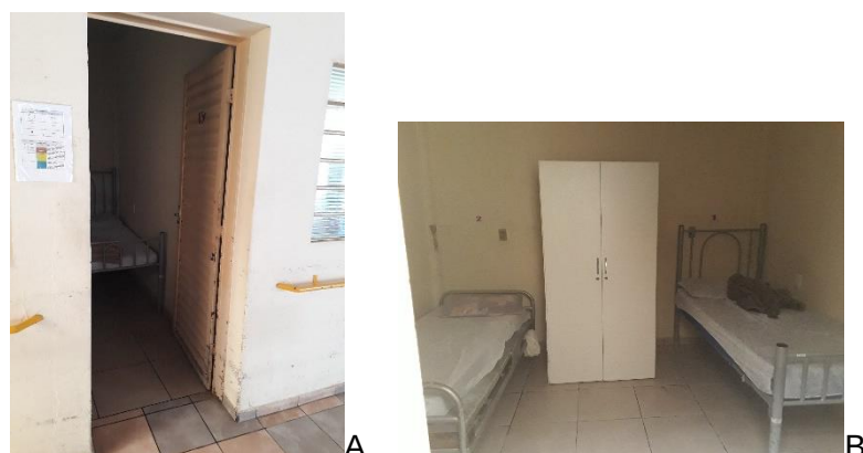
Figuras 49 A e B – Os dormitórios ficaram escuros, mesmo durante o dia, devido à cobertura irregular das circulações.
