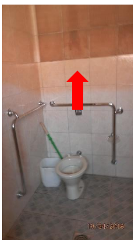
Figura 59 – Presença de descolamento dos revestimentos cerâmicos das paredes.
