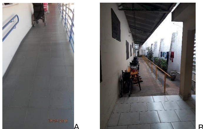
Figuras 77 A e B – Ausência de sinalização direcional tátil em circulações nas ILPI I (A) e ILPI II (B).
