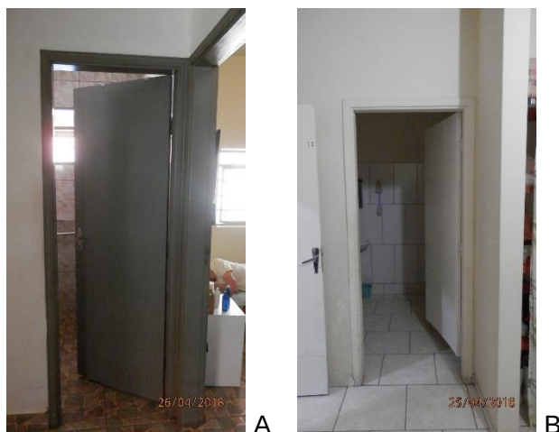
Figuras 74 A e B – Portas dos banheiros em alguns setores de dormitórios das duas ILPI's, com abertura inadequada (A) na ILPI I e (B) na ILPI II.
