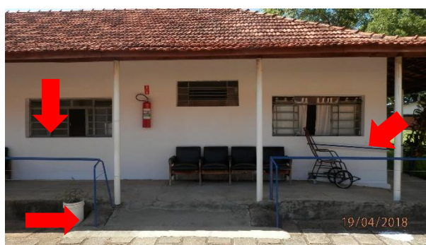
Figura 76 - Presença de corrimão, mas inadequado, em áreas de circulação externa e rampas muito inclinadas (ILPI I).
