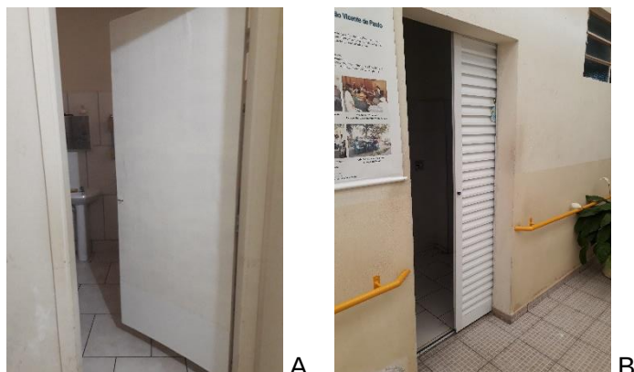
Figuras 39 A e B - Portas dos banheiros da ILPI 2 dispositivo de abertura para dentro do ambiente e sem maçaneta (A); Porta de correr nos banheiros masculinos(B).
