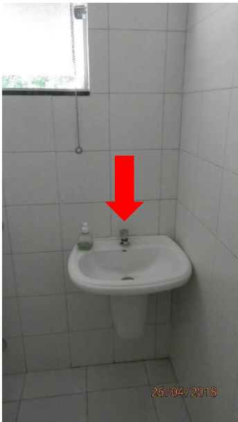
Figura 94 – Os lavatórios do Setor E (Centro-Dia) não possuem barra de apoio e o comando de acionamento da torneira não são adequadas para o uso de pessoas idosas.
