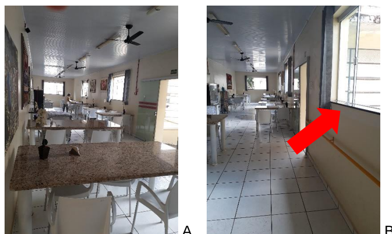
Figuras 81 A e B – Refeitório da ILPI II, distância entre as mesas (A) e janelas inadequadas (B).
