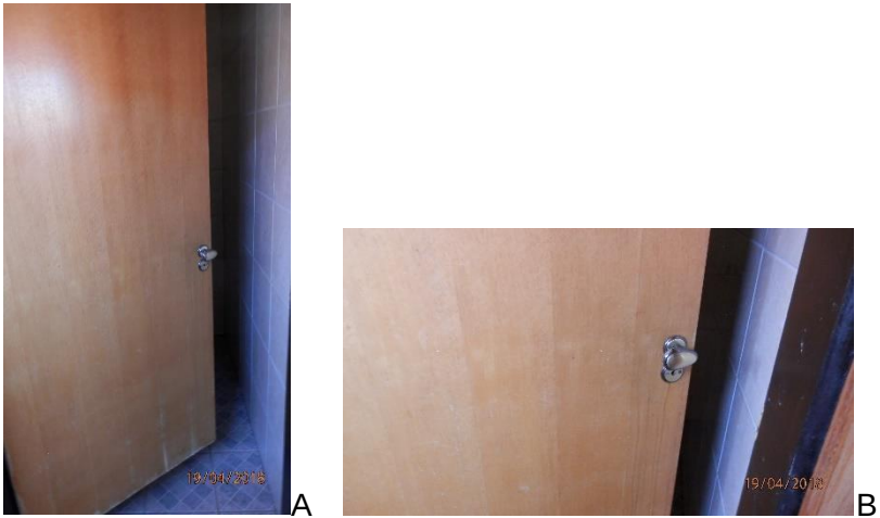
Figuras 87 A e B – As maçanetas das portas das cabines dos vasos sanitários não são adequadas para ambientes voltados ao público idoso (modelo Bolota).
