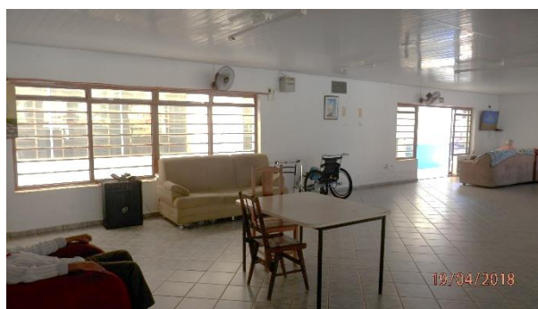
Figura 85 – Esquadrias com dispositivo de abertura inadequado, ILPI I.
