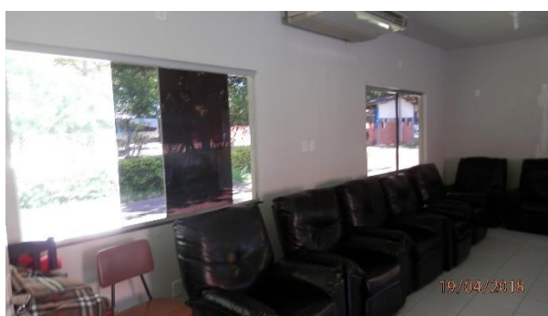
Figura 92 – As janelas do setor do Centro-Dia possuem dispositivos de abertura inadequados.
