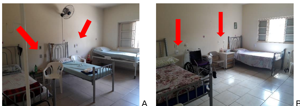
Figuras 34 A e B – Presença de interruptores em paralelo nos dormitórios da ILPI 2.
