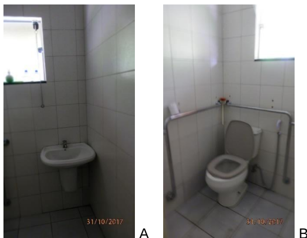
Figuras 66 A e B – Lavatório com coluna suspensa (A) e Vaso sanitário com barras de apoio na lateral e ao fundo (B).
