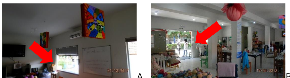
Figuras 67 A e B - As janelas são de vidro temperado com dispositivo de abertura de correr (A) e as portas são de vidro temperado, sem faixas de sinalização, sem maçaneta (B).
